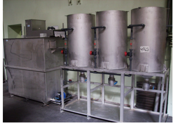
Aktivkohlefiltersystem - Wasseraufbereitung mit Aktivkohle
