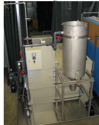
Wasseraufbereitung mit Aktivkohle
