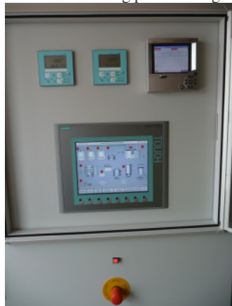
Touchsteuerung pH Messung
