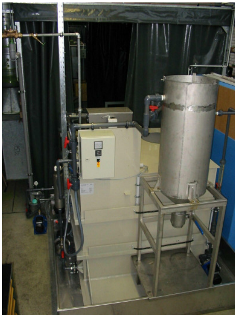
Aktivkohlefilteranlage im Kreislauf (Rissprüfung) Standort: Luftwaffe
