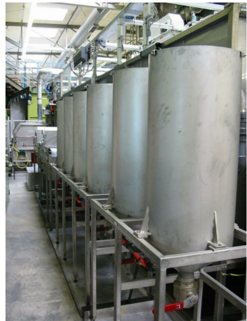
Aktivkohle 2 x 3 Doppelfiltersystem Standort: Motorenhersteller
