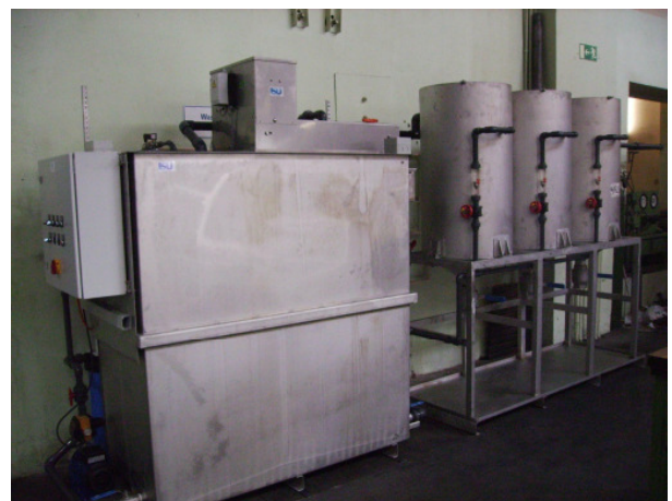
Aktivkohlekreislaufsystem 3-fach Standort: Turbinenhersteller
